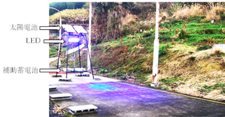
図2 太陽電池とLEDを組み合わせた独立型単色光補光装置
