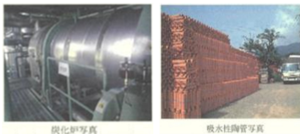
図 6.1 Y 浄化センター炭化設備&吸水性陶管
