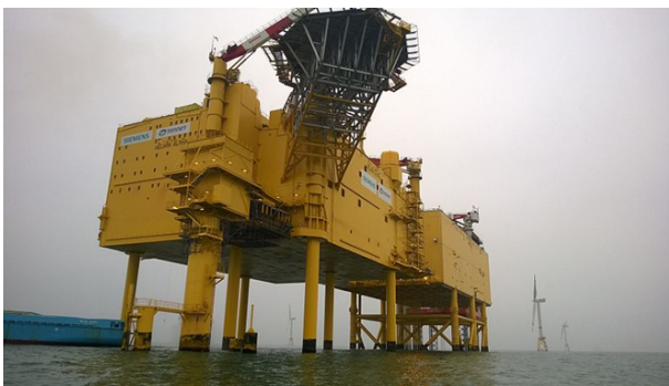
図10 洋上変電所の例 12) (ドイツ・ヘルウィン1変換所)
