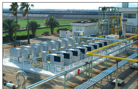
写真3 下水処理場導入事例写真
