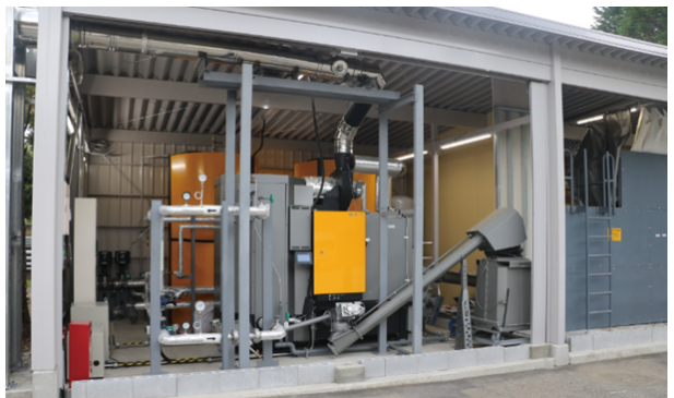
図8 六甲国際ゴルフクラブのバイオマスボイラー
